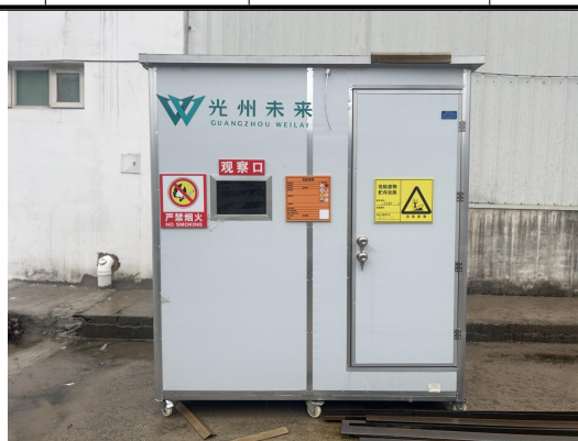
危废暂存间照片
