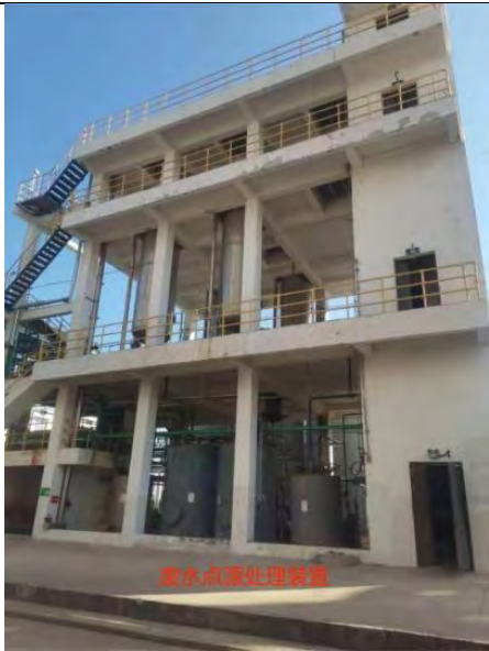
氯苯装置区废水预处理
