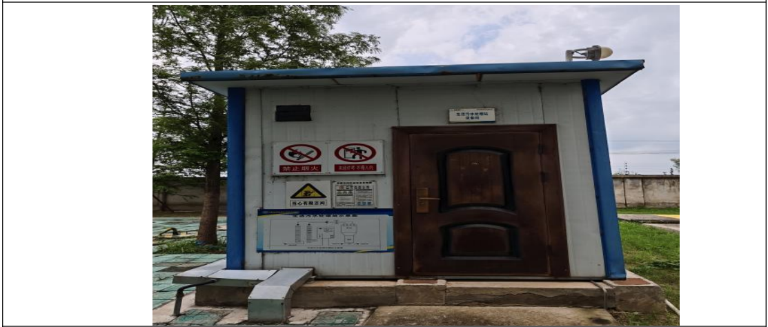
生活污水设备间
