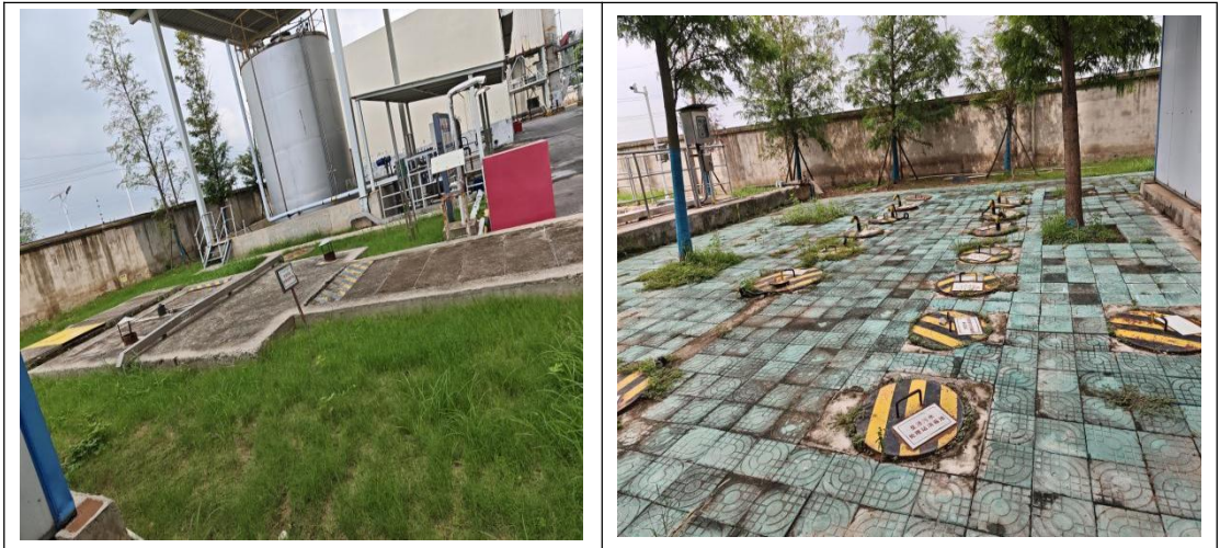
一体化地埋式污水处理设施
