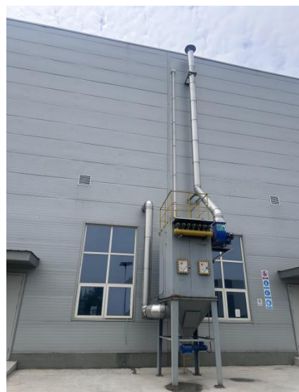
布袋除尘器装置及排气筒
